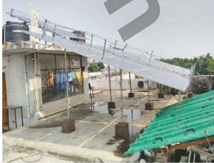
इंदिरानगर कॉलोनी में संजय तिवारी के घर की छत पर लगा सोलर पॉवर प्लांट
